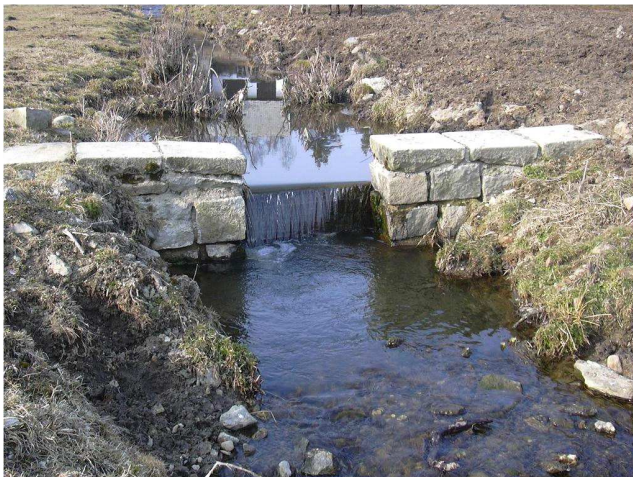
Pohled na stavidlo
