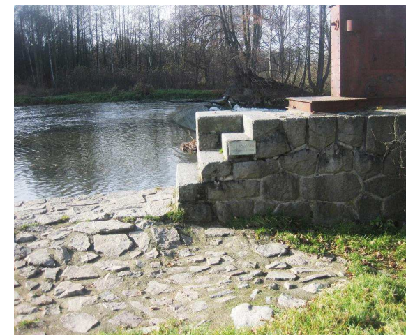
Nadjezí s ovládáním klapky v propusti
