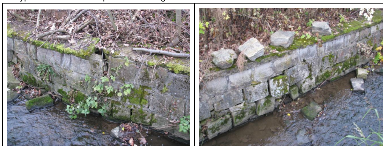
Obr. 5. Poškozená úprava koryta
